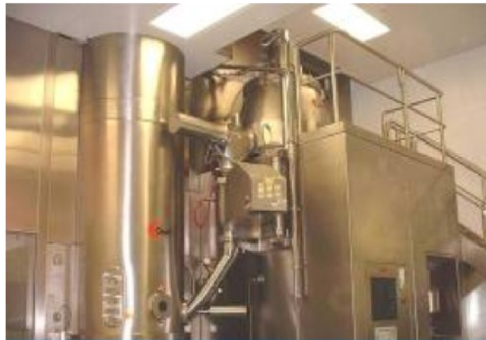
Figura 9: Sala de Granulação da Fármacos do Brasil onde a mistura dos pós é granulada.
