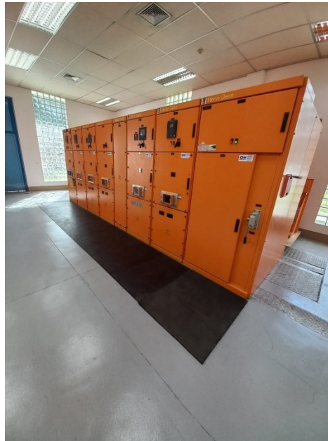
Figura 14: Painéis elétricos da subestação de energia da empresa Fármacos do Brasil
