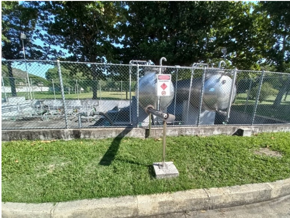
Figura 19: Tanques aéreos de armazenamento de diesel da Fármacos do Brasil.
