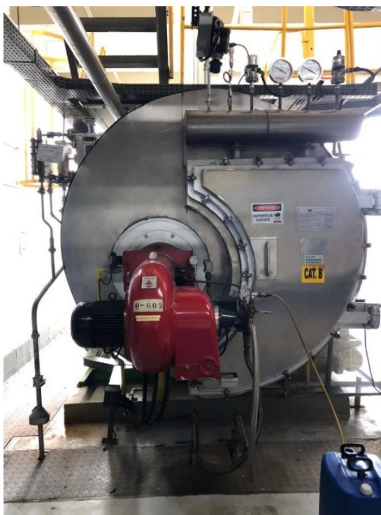
Figura 21: Caldeira industrial utilizada na empresa Fármacos do Brasil
