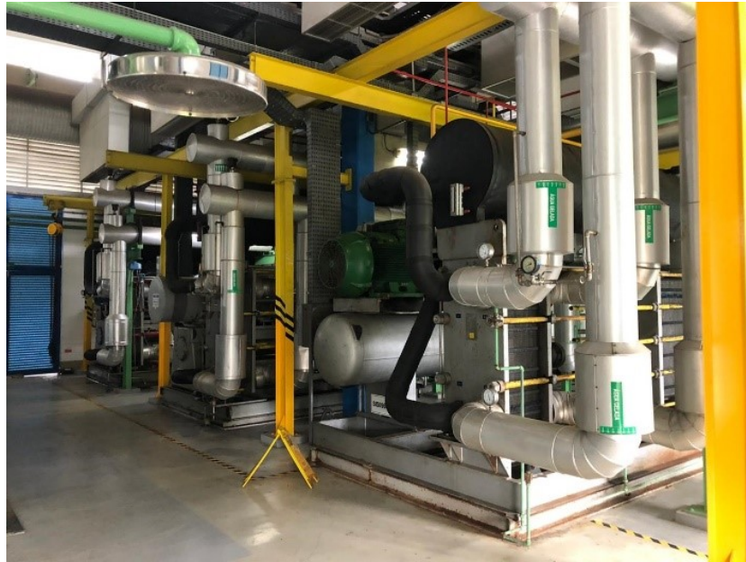
Figura 20: Equipamento do tipo Chiller industrial utilizado na empresa Fármacos do Brasil
