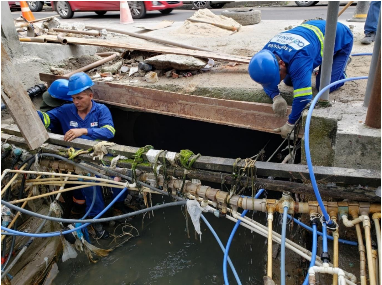
Figura 1 - Ligações clandestinas no bairro do Compensa no estado do Amazonas, 2019.
