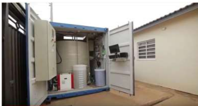
Figura 24 – ETEC automatizada da Tigre para tratamento de águas cinzas
