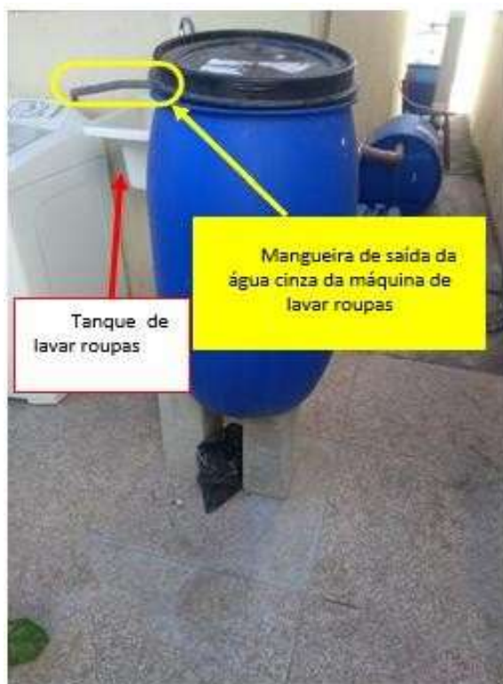
Figura 45 – Ponto de captação e descarte da água cinza oriunda da máquina de lavar roupas
