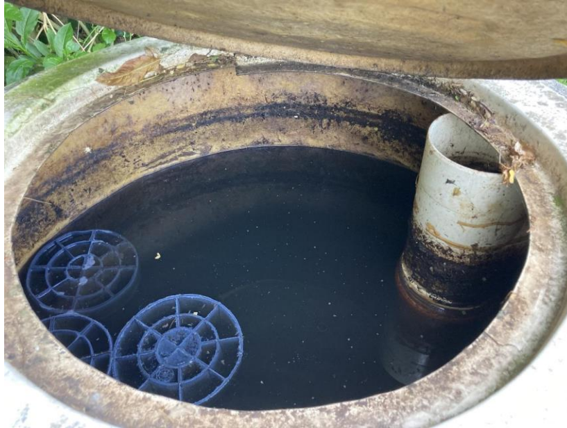
Figura 3 - Vista interna do reator UASB 1
