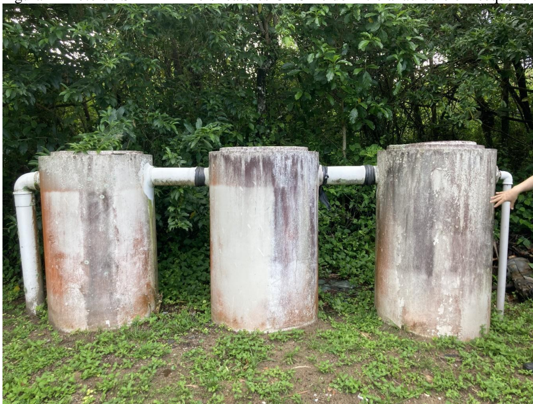
Figura 2 - Foto do SAATE - Dois reatores UASB e do filtro anaeróbio em sequência
