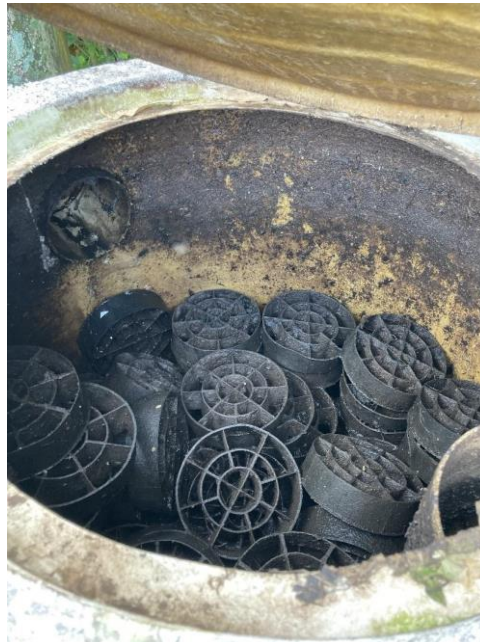
Figura 4 - Vista interna do reator UASB 2 com o recheio de mídias plásticas aparente
