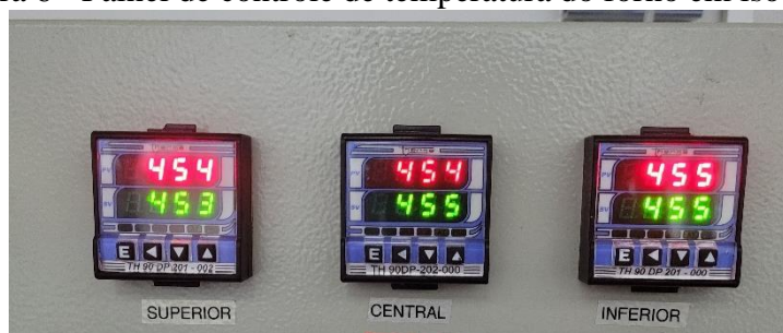
Figura 6 - Painel de controle de temperatura do forno em isoterma
