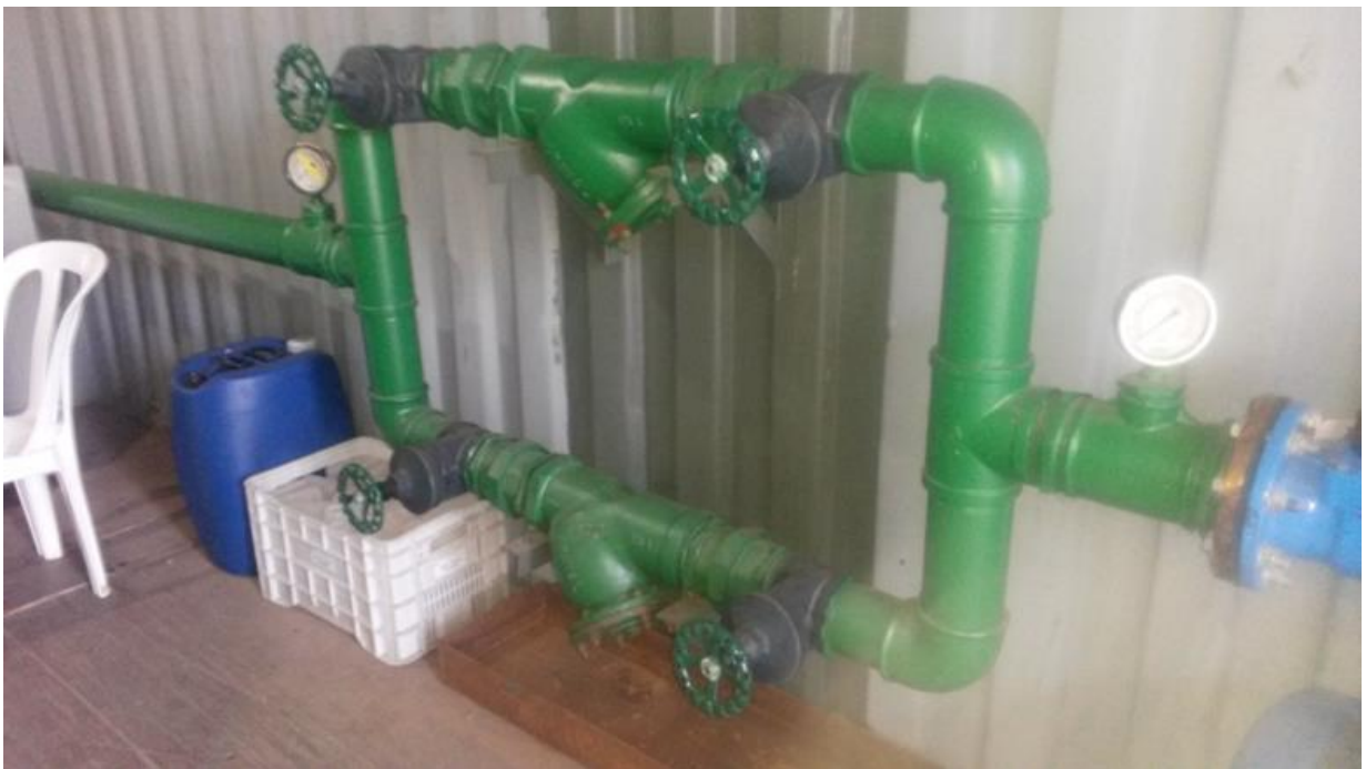
Figura 22 - Foto interna do sistema de válvulas e filtros antes do bombeamento de hipoclorito de sódio no sistema de reúso de água na ETE Alegria.
