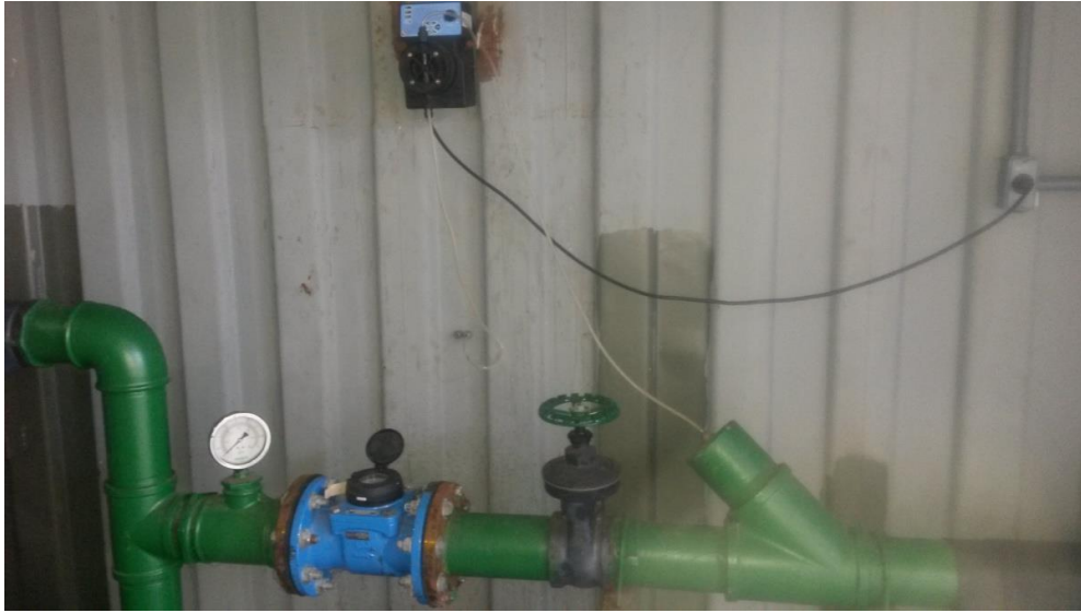
Figura 24 – Foto interna da conexão da bomba dosadora de diafragma no sistema de reúso da ETE Alegria.
