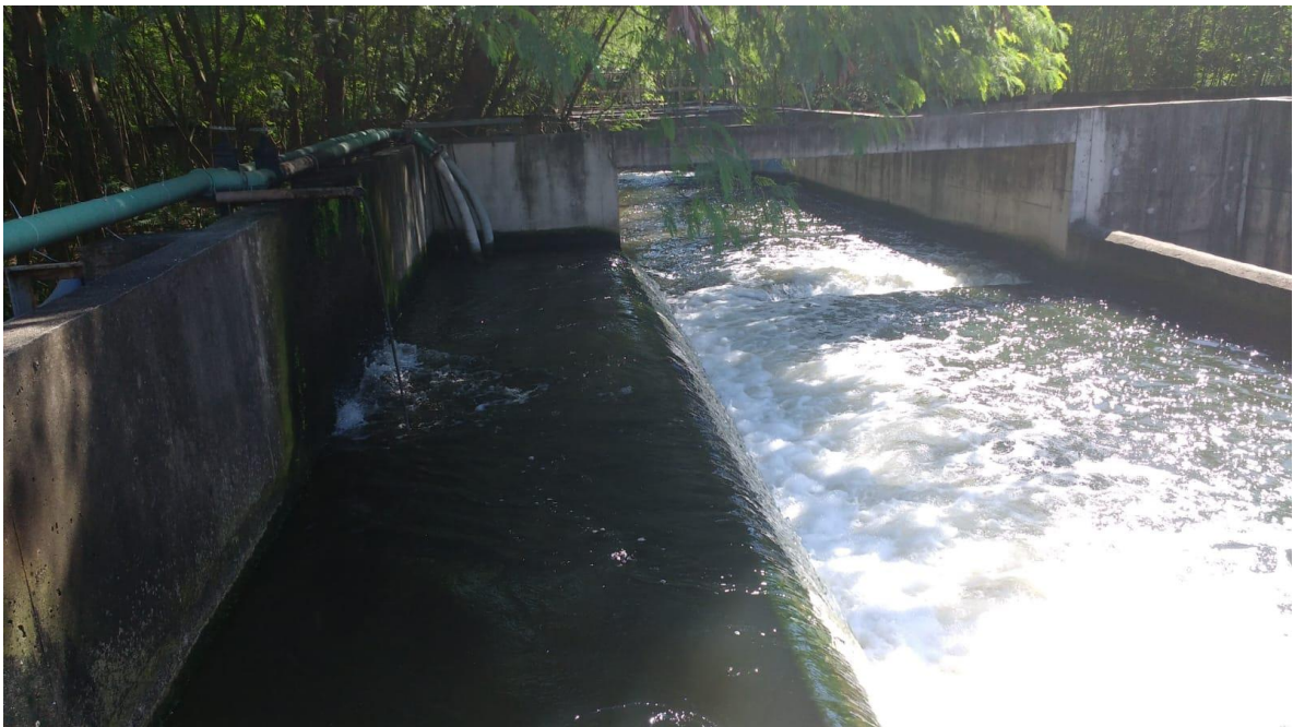
Figura 21 - Foto externa do sistema de reúso de água ETE Alegria – imagem lateral da captação de efluentes tratados por bombas submersíveis insumo e do sistema de condução de efluentes tratados com direcionamento ao corpo hídrico.
