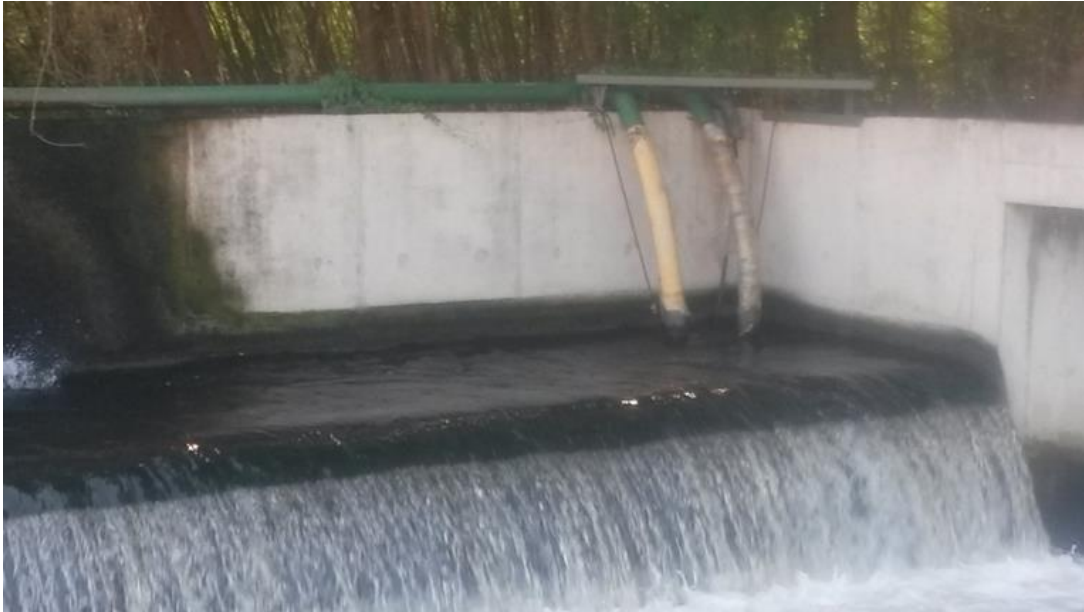
Figura 20 - Foto externa do sistema de reúso de água ETE Alegria – imagem frontal da captação de efluentes tratados por bombas submersíveis.
