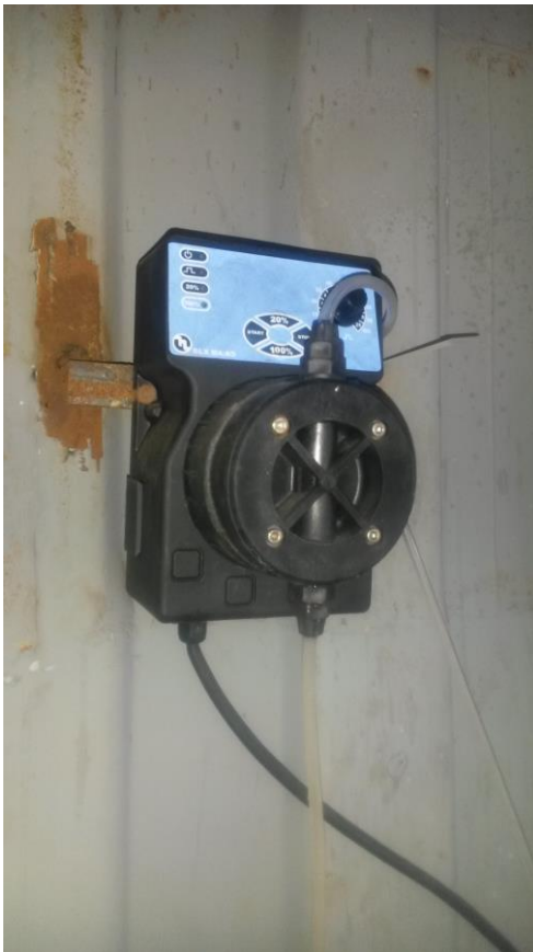
Figura 25 - Foto interna da bomba dosadora de diafragma de 18 L/h utilizada no sistema de reúso da ETE Alegria.
