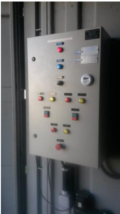
Figura 26 - Foto interna do painel de alimentação e controle das bombas utilizado no sistema de reúso de água da ETE Alegria.
