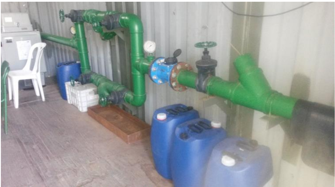
Figura 23 - Foto interna da bombona de 50 L de hipoclorito de sódio e da conexão de captação antes do bombeamento de hipoclorito de sódio no sistema de reúso de água na ETE Alegria.
