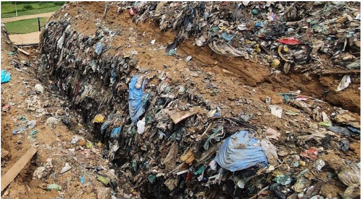
Figura 15 - Escavação de vala para a implantação de drenagem de lixiviados (à esquerda da foto) e na direita os resíduos que foram retirados para abertura da vala. Fonte: CTR.
