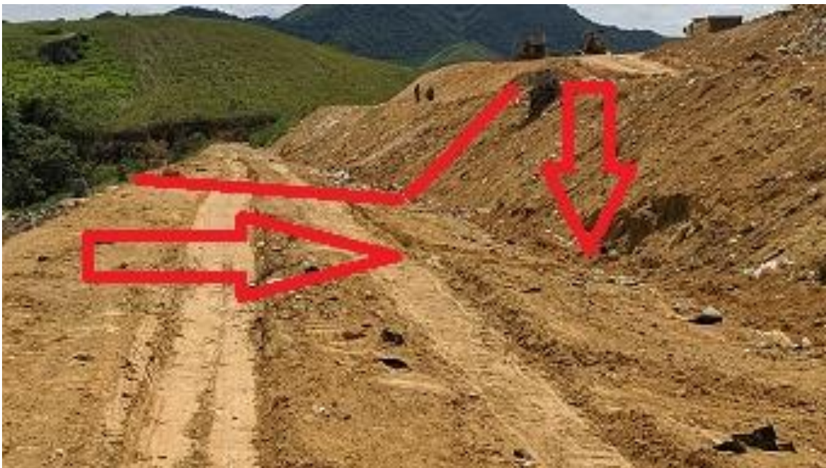
Figura 20 - Inversão do greide em direção ao pé do talude. Fonte: CTR.
