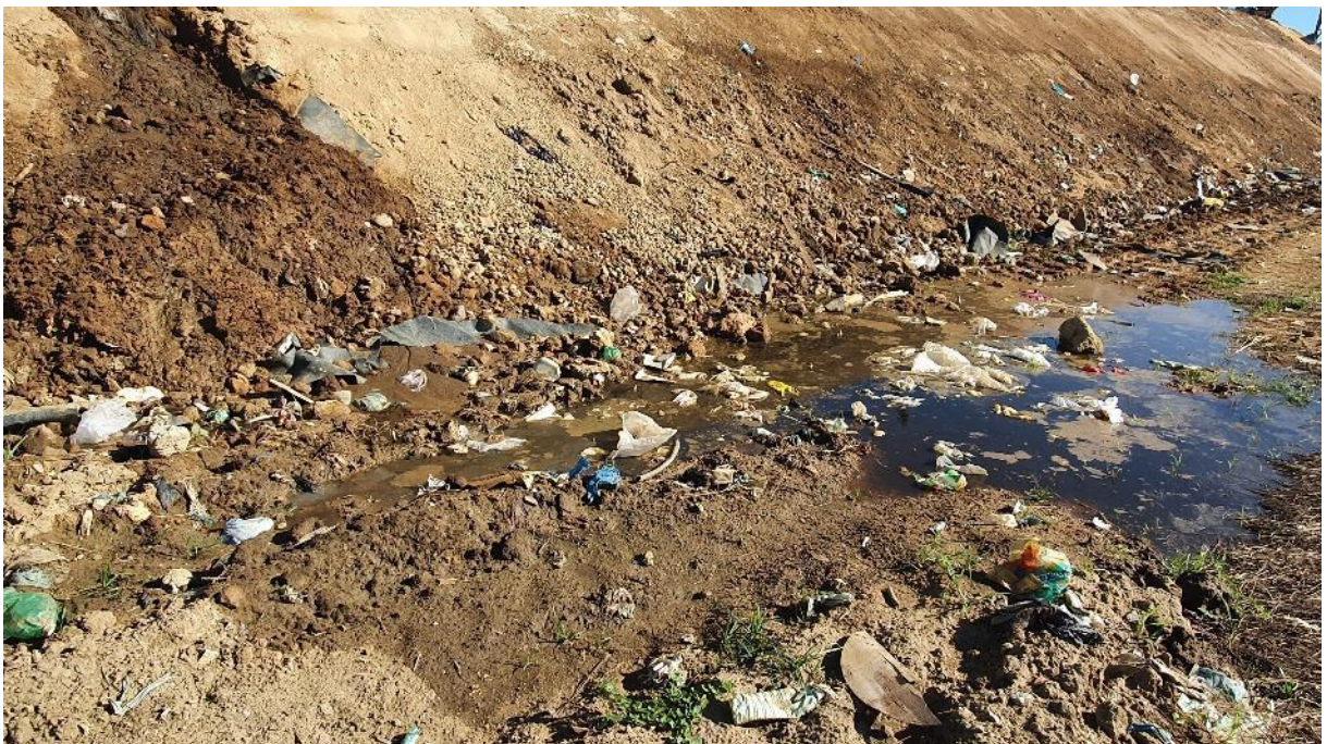
Figura 39 - Afloramento de lixiviados na face do talude. Fonte: CTR.
