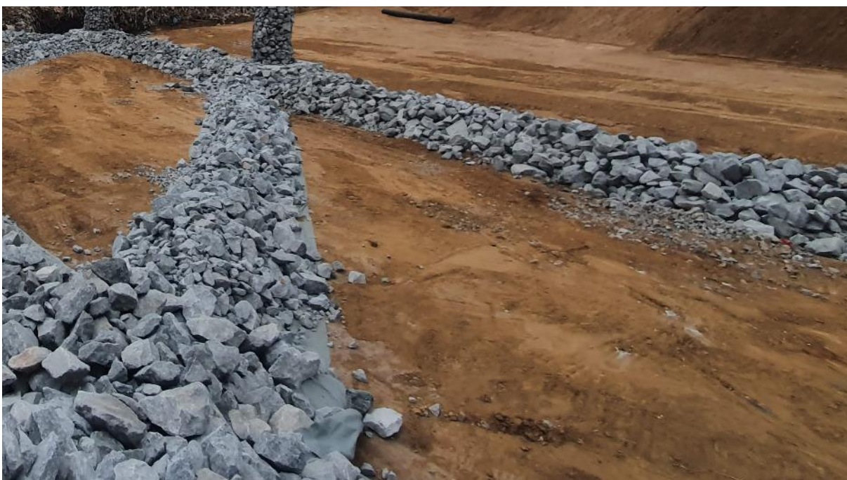
Figura 31 - Dreno principal no meio da área com tubulação e secundários direcionando os lixiviados ao dreno principal. Fonte: CTR.
