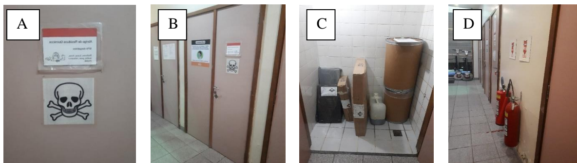
Figura 16 - Abrigo externo de RSS do grupo B
