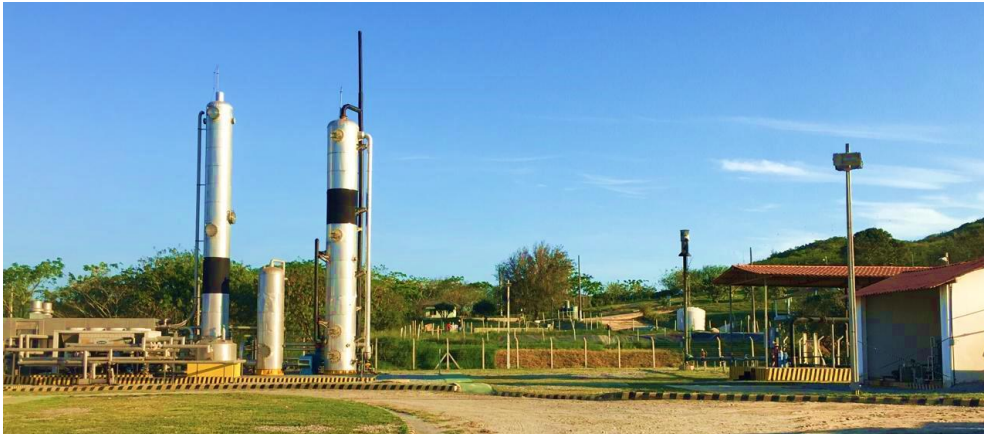
Figura 29 – Planta de purificação de biogás GNR Dois Arcos
