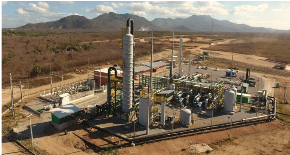
Figura 28 – Planta de purificação de biogás GNR Fortaleza
