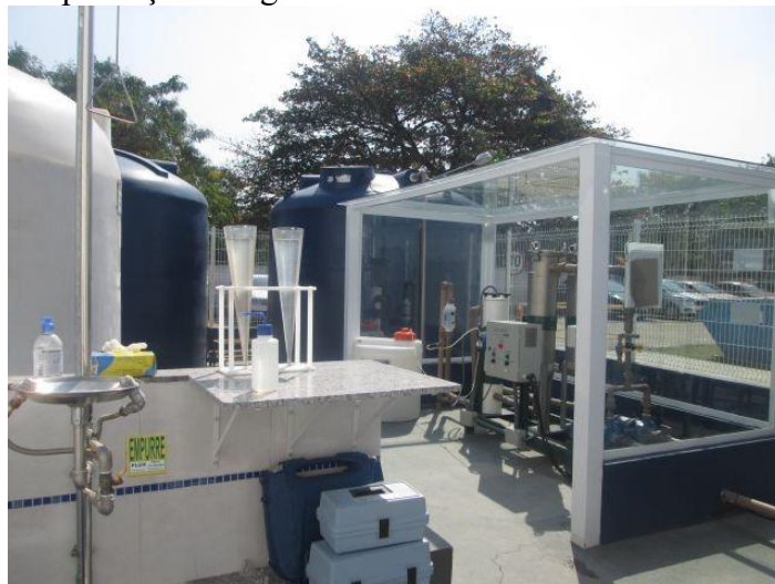
Figura 21 – Sistema de produção de água de reúso na ETE Deodoro.
