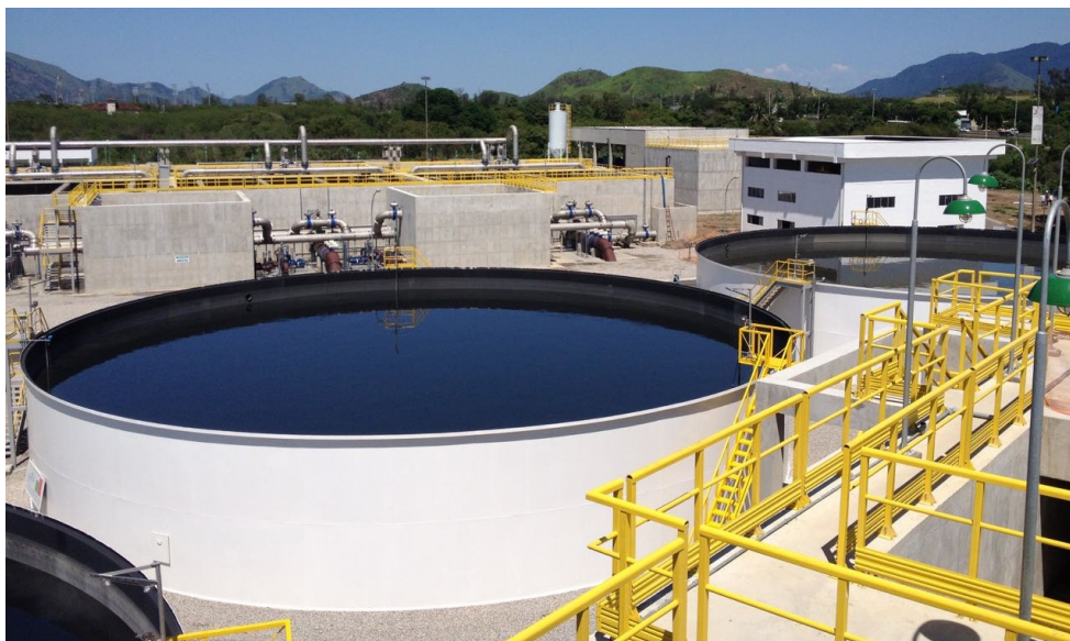
Figura 19 - Tanque de equalização.
