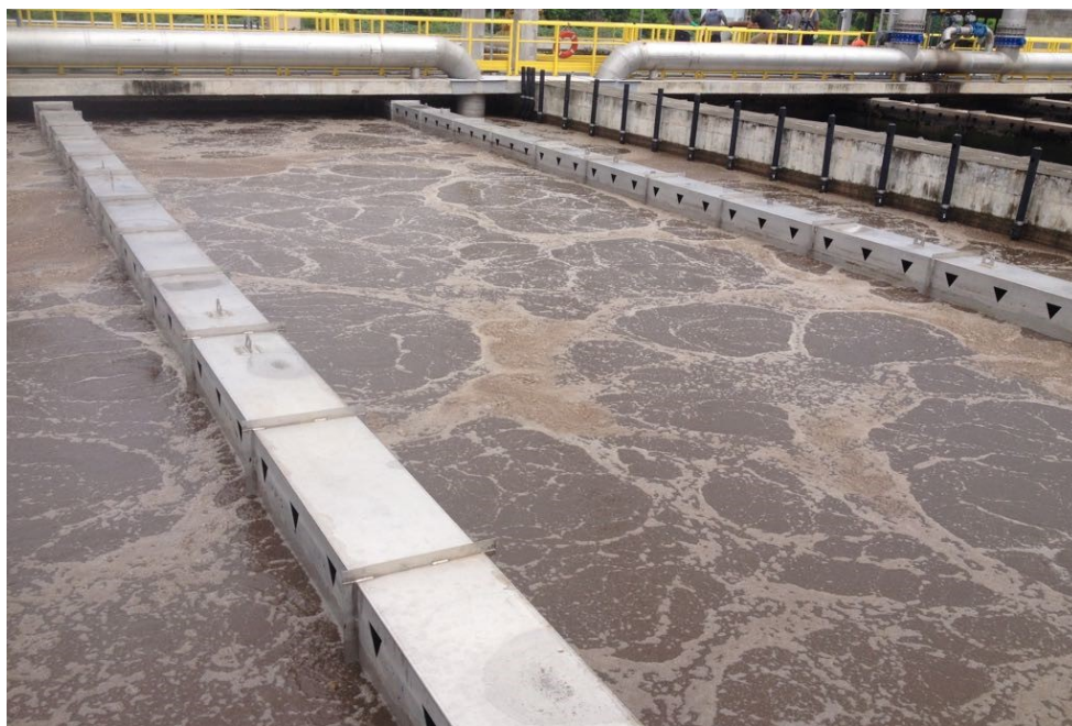
Figura 21 - Reator biológico em fase de aeração.
