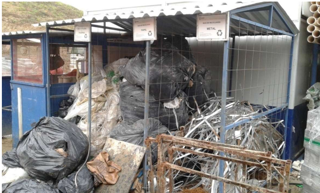
Figura 30 - Segregação dos RCC em baias em um canteiro de obras.
