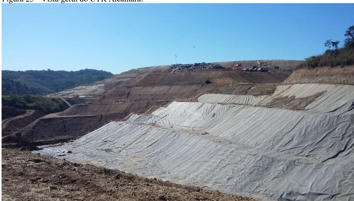
Figura 25 - Vista geral do CTR Alcântara.
