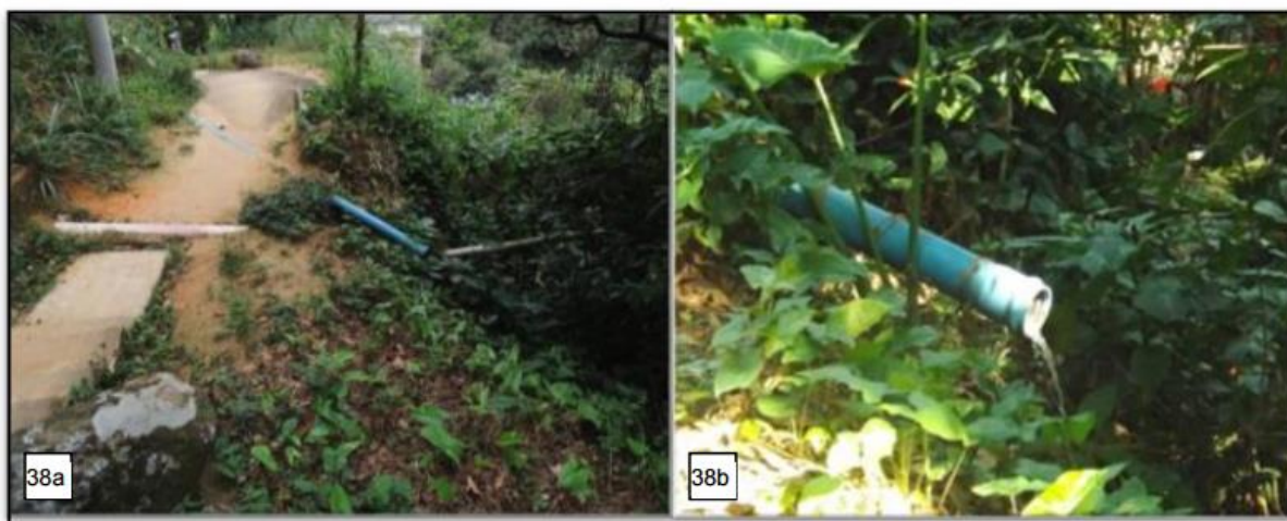
Figura 38 - lançamento de esgoto doméstico in natura no rio. 38a- percurso do encanamento de esgoto; 38b- lançamento de esgoto diretamente no rio Cachoeira.
