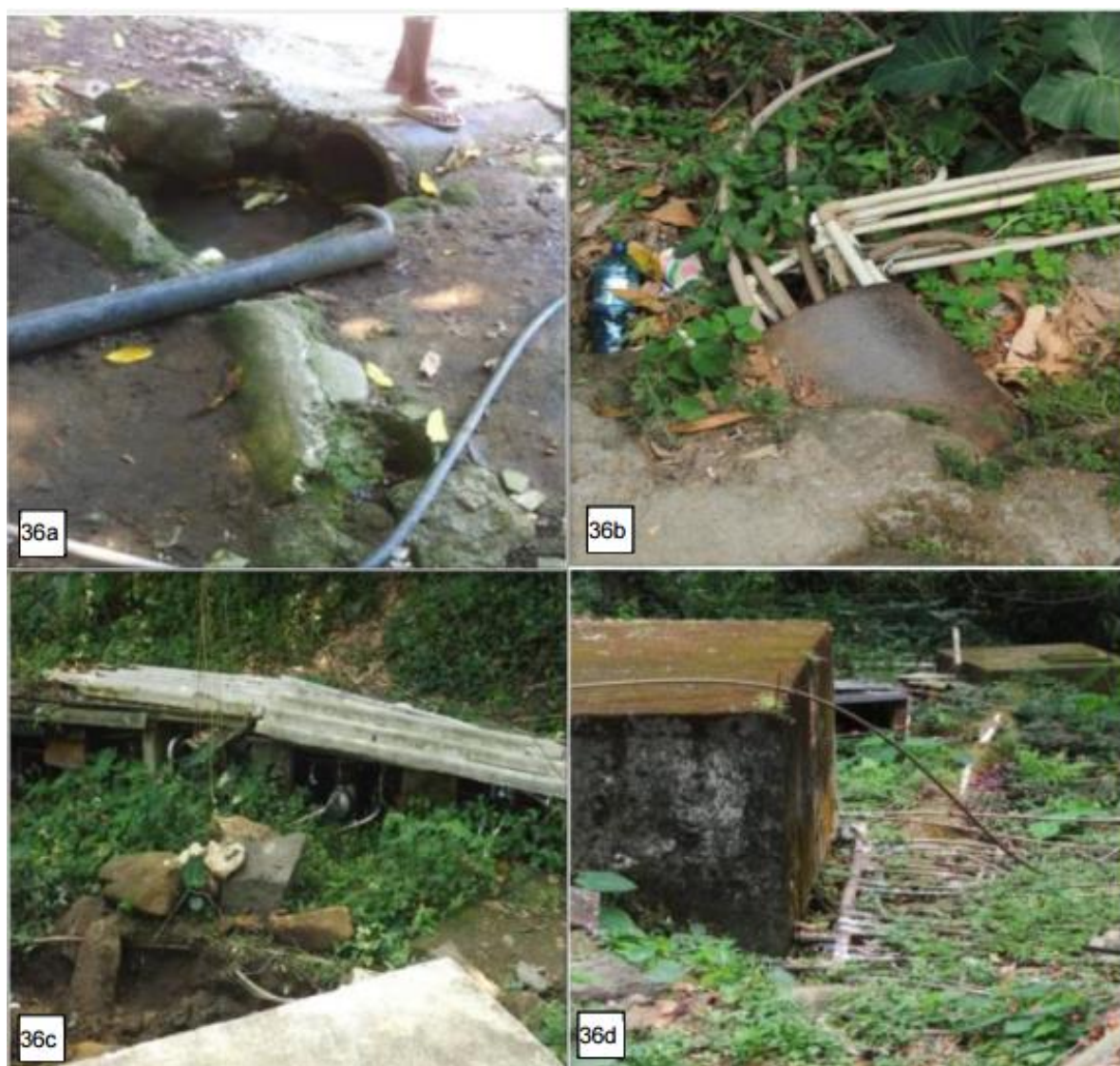
Figura 36- Bombas e encanamentos. 36a- ramais de recalque; 36b- sistema de bomba; 36c- sistema de bomba; 36d- ramais de recalque.
