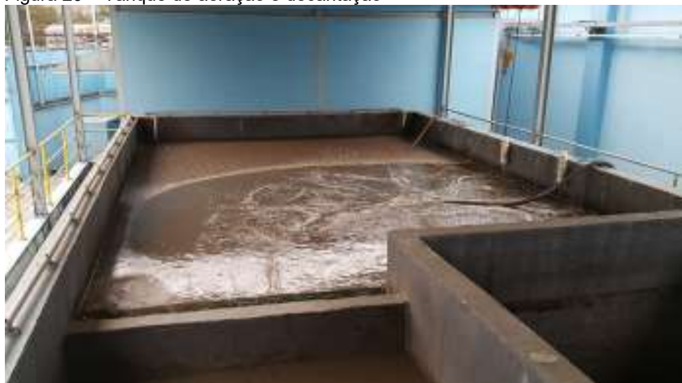
Figura 20 – Tanque de aeração e decantação
