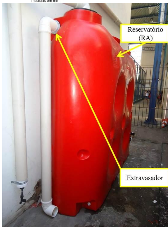
Figura 21: Reservatório com capacidade para 2.460 litros (Harvesting Brasil, 2012)
