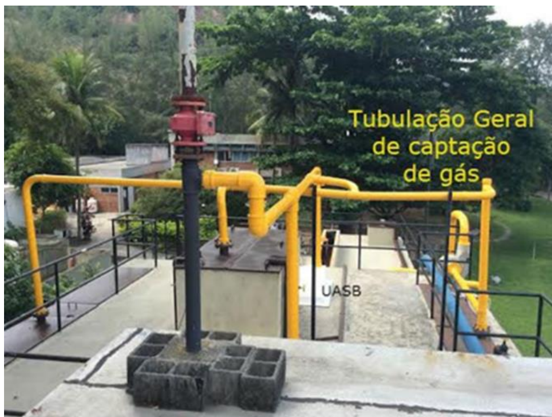
Figura 2.3 - Tratamento secundário do efluente na estação.
