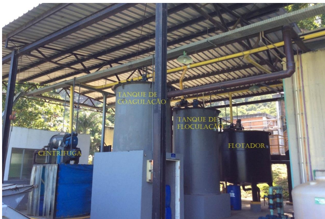
Figura 2.2- Tratamento primário do efluente na estação.
