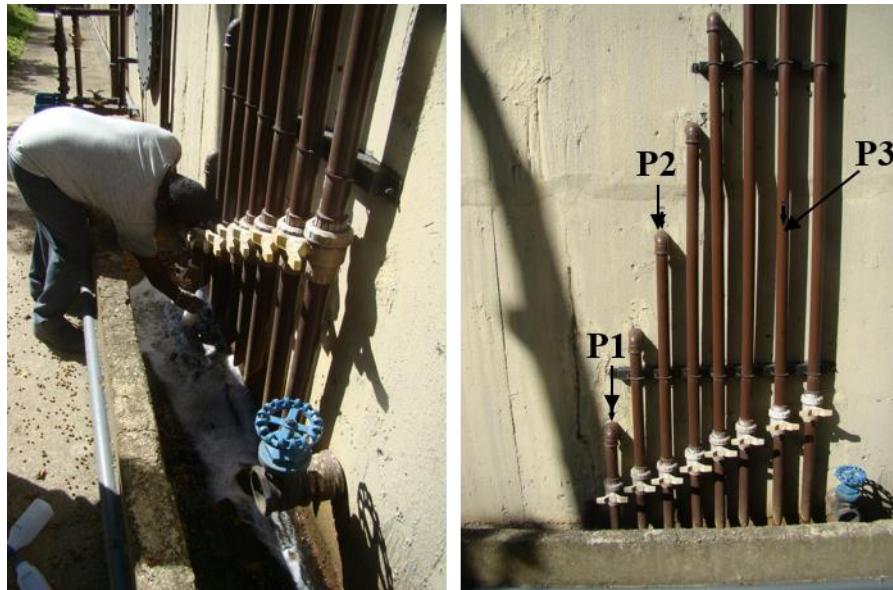
Figura 5 – Pontos de coleta do reator anaeróbio.
