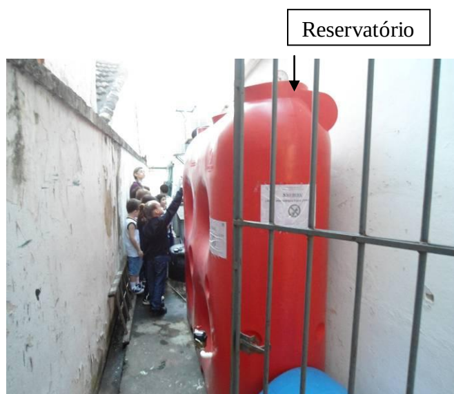
Figura 23 - Visita ao sistema de captação de água pluvial do CAP-UERJ
