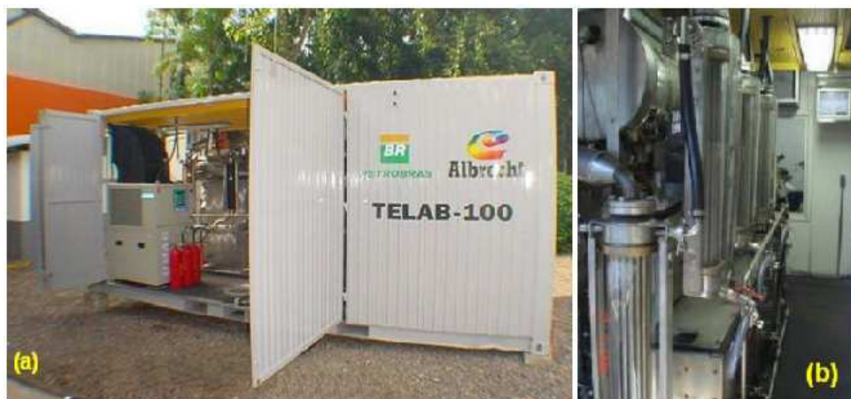
FIGURA 12 (a) Unidade piloto TELAB 100 do processo de Tratamento Térmico de Resíduos e Materiais Multifásicos – TTRM; (b) TELAB 100 – Vista lateral dos sistemas de condensação (PICKLER, 2010)
