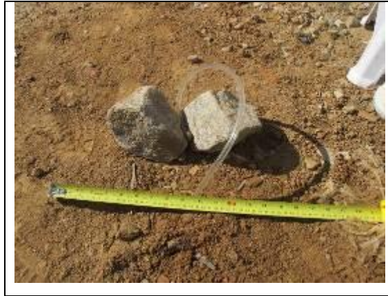
Figura 29 – Detalhe da instalação do dispositivo de DMPC concluída na camada de cobertura.
