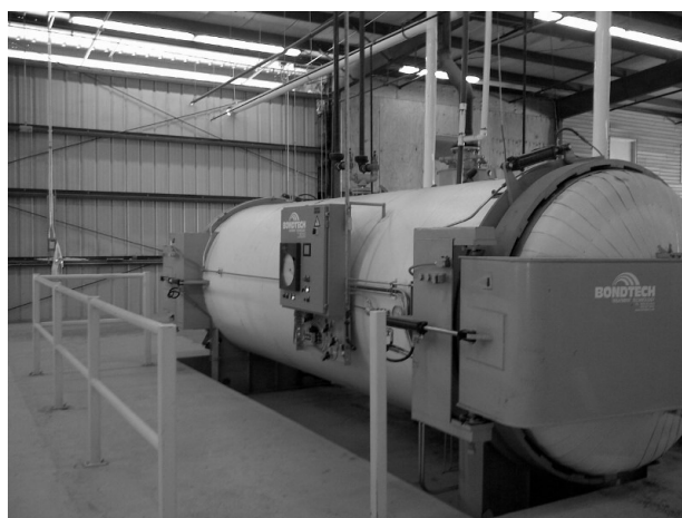
Figura 44 – Unidade de Autoclavagem de RSS - Orlando (USA) Fonte: Autor, 2012
