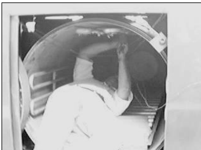
Figura 6 – Colocação de sensores de temperatura ao longo da câmara Fonte: Baumer, 2008
