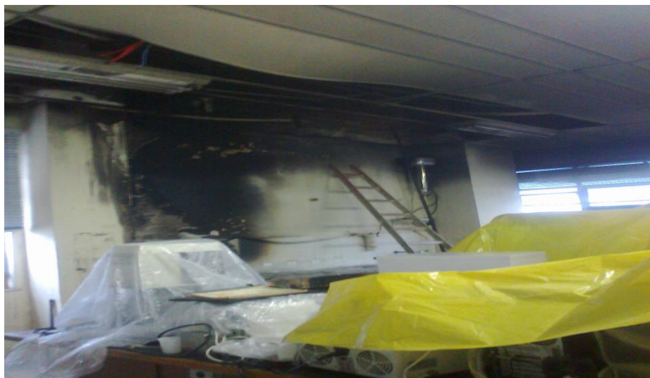
Figura 20: Vista parcial do laboratório de pesquisa (PPGEQ / DQA) após o incêndio
