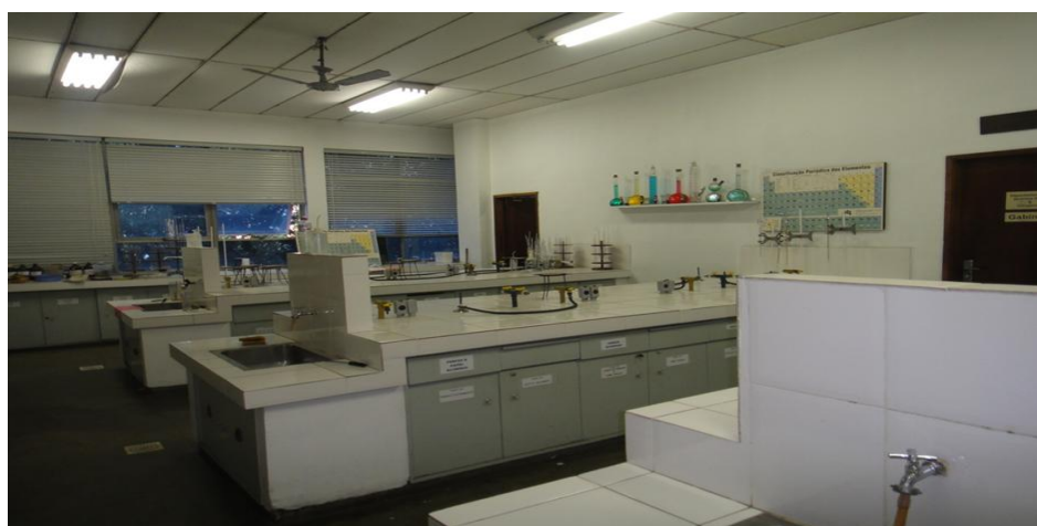
Figura 33: Laboratório 323 de Ensino com as luminárias em desacordo com a Norma Regulamentadora no. 17
