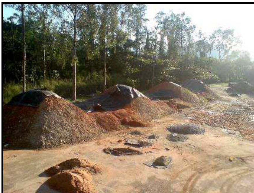
Figura 28 – Rompimento da manta de PEAD devido aos fortes ventos. Deslocamento da argila que aplainava as células devido à força da água das chuvas.
