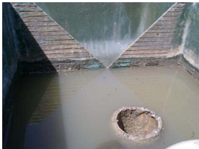
Figura 10 - Caixa de controle da vazão, com cano de retorno.
