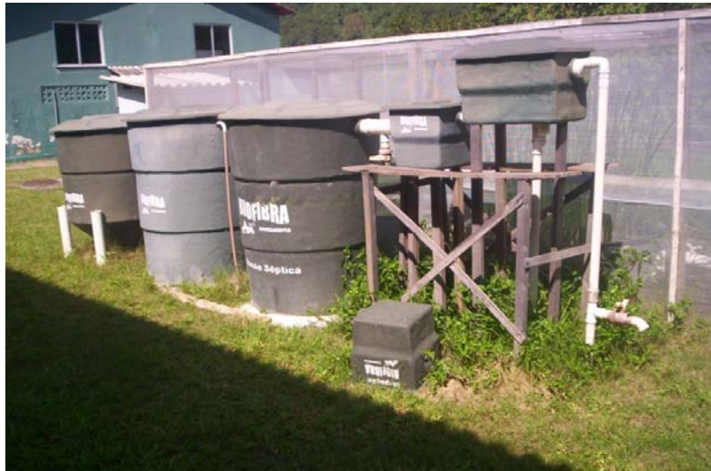
Figura 13 - Vista dos tanques de tratamentos prim rio e secund rio.
