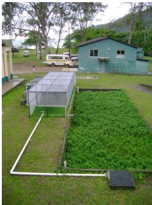
Figura 14 - Vista do Ecossistema Engenheirado e wetland constru do do sistema de tratamento original (Foto: A.L.S. Salom o).
