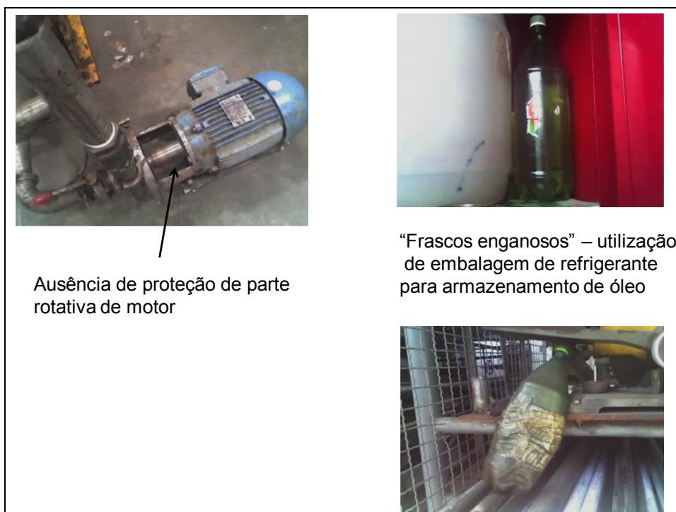
Figura 13 - Condições de risco
