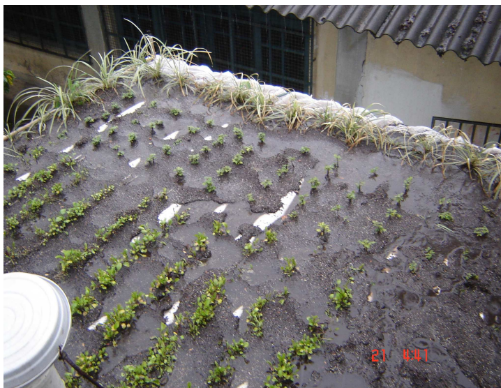
Figura 4.3 - Detalhe da erosão causada pela simulação de chuva sobre o telhado verde – intensidade pluviométrica máxima de 42 mm/h.
