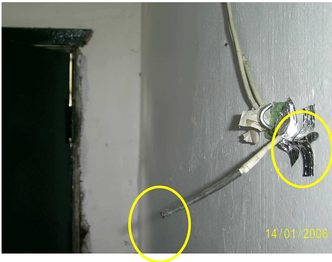
Figura 3.4 - Detalhe de instalação dos sensores dentro da edificação por parede (1 sensor encostado parede e 1 afastado dez centímetros).
