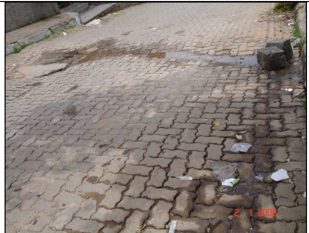
Foto 39: Vazamento de esgoto na Praça da Maromba
