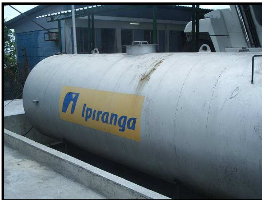
Figura 4.8 - Tanque de armazenamento de combustíveis
