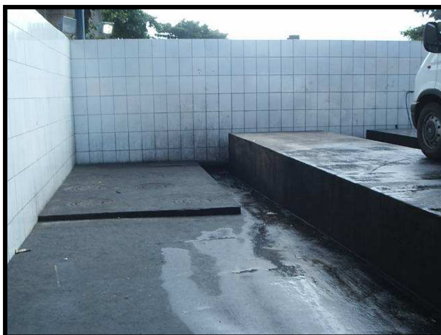
Figura 4.5 - Caixa separadora de água e óleo
