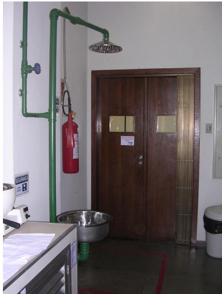
Figura 22: Detalhe do chuveiro de descontaminação
