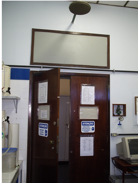
Figura 15: Detalhe do chuveiro de descontaminação
