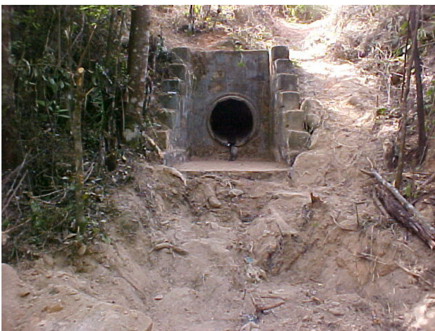
Figura 45: Acidente com óleo BPF- Área de drenagem de águas pluviais da via, após limpeza. (Fonte e autoria: FEEMA/SCPA - Carlos Eduardo Strauch.)
