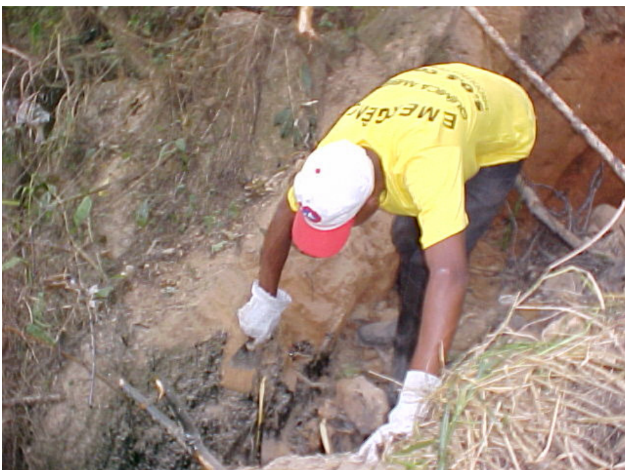
Figura 34: Acidente com óleo BPF- Limpeza manual da área contaminada (raspagem). (Fonte e autoria: FEEMA/SCPA - Carlos Eduardo Strauch.)
