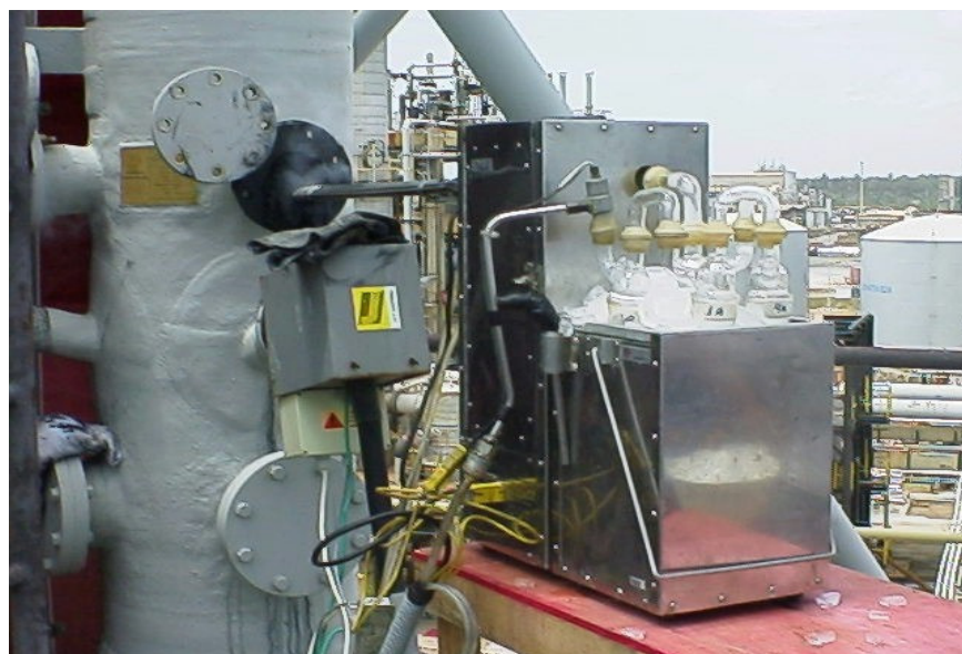
Figura 1: Sistema convencional para medição de gases em chaminés
