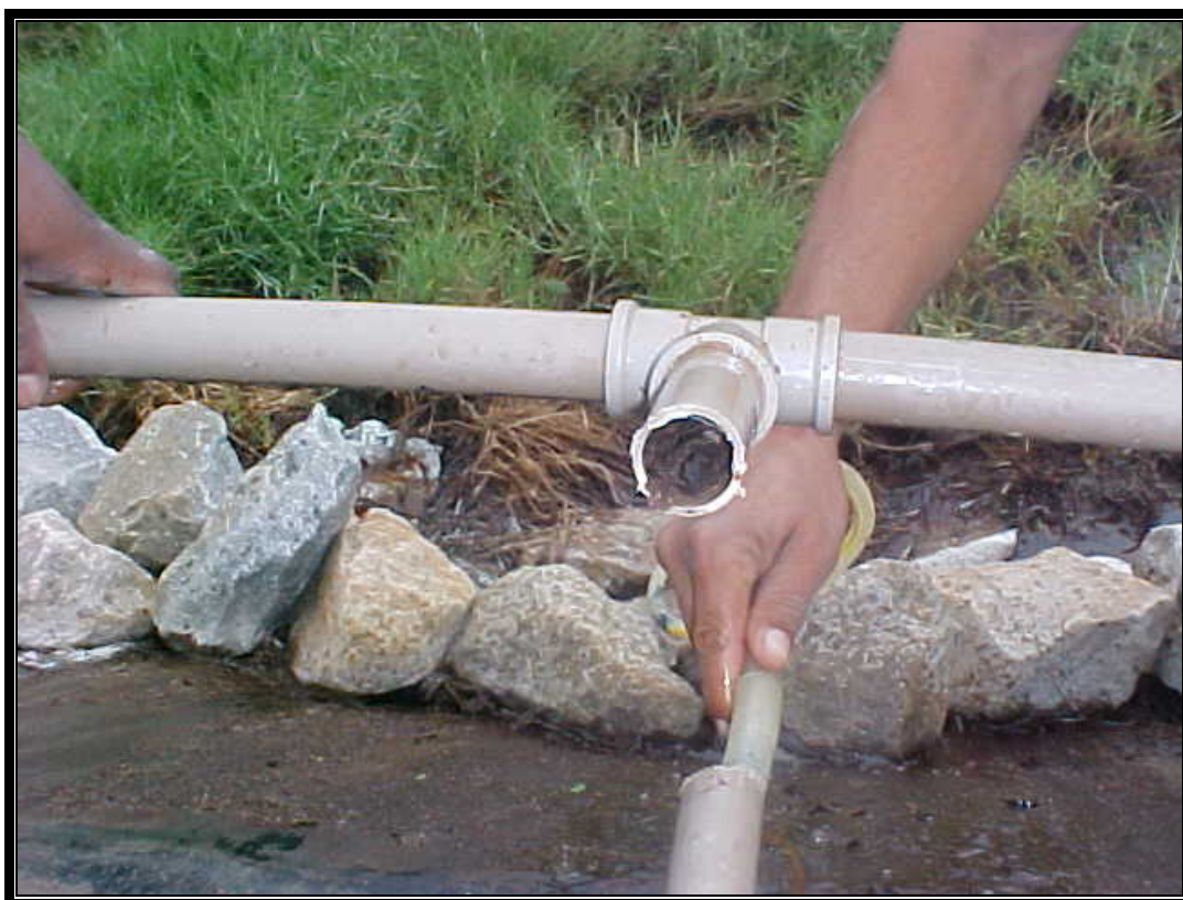
Foto 39 Tubulação entupida por material depositado
