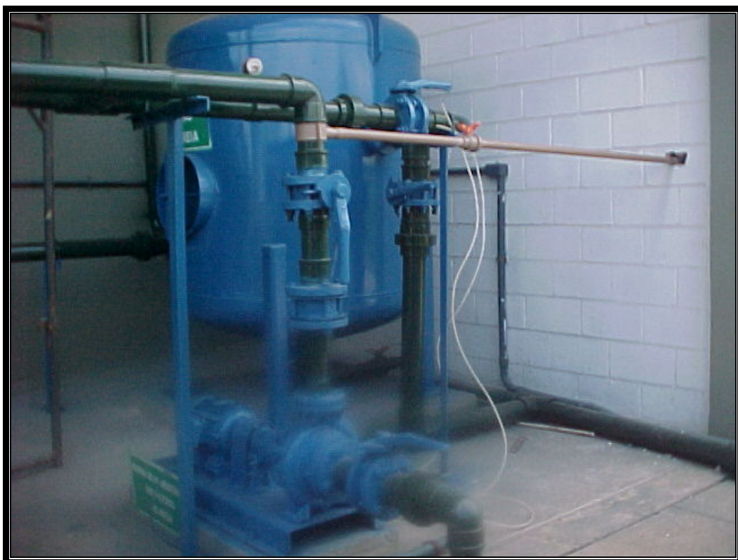
foto 25 Saída da bomba do filtro de areia.
