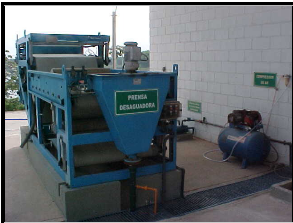
Foto 22 Prensa desaguadora do lodo.
