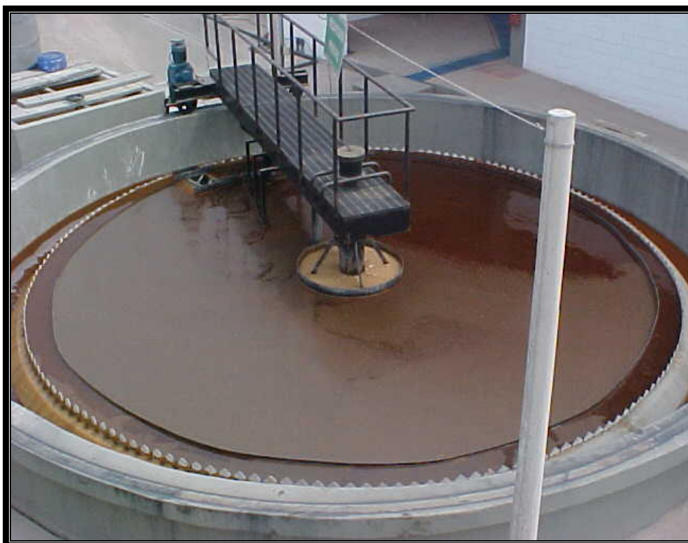
Foto 13 Calha periférica do decantador.
