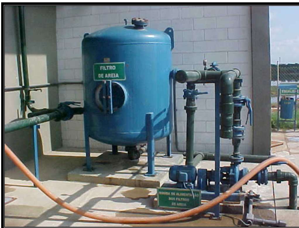
Foto 15 Filtro de areia.
